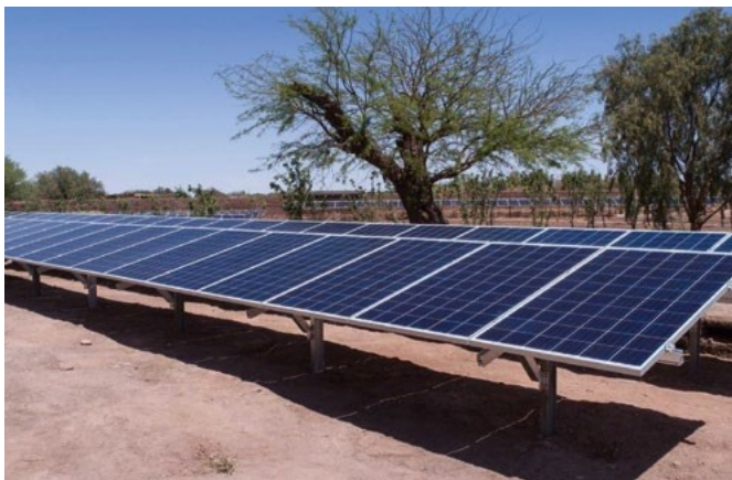
Die Anlage ist leicht zu warten und wird kontinuierlich fernüberwacht. – La instalación cuenta con un mantenimiento sencillo y puede ser monitorizada a distancia de forma continua.
